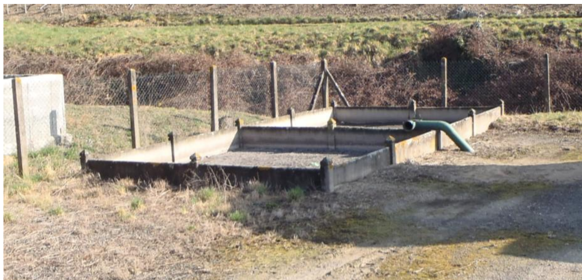
Lits de séchage des boues
