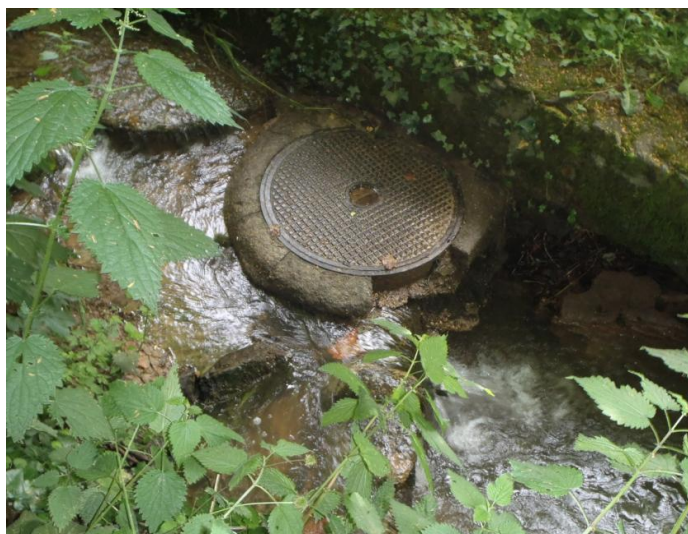
Regard endommagé dans le lit mineur du cours d'eau
