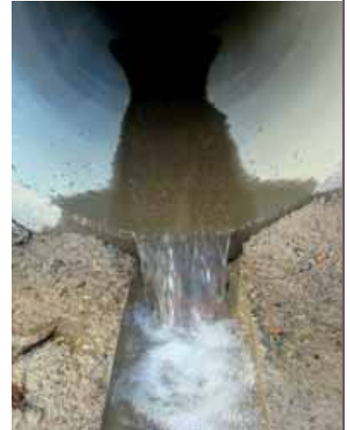
Trop pentue et faible lame d'eau ! Pas de rugosité
