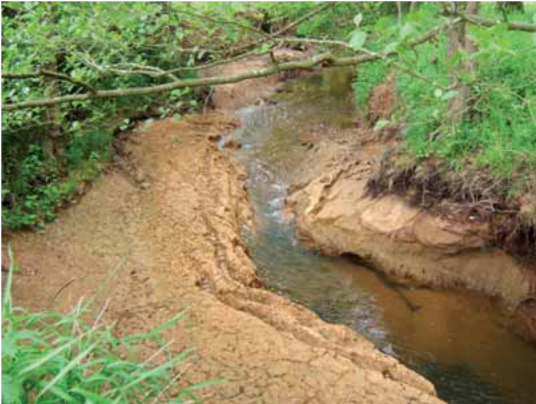
Enfoncement du lit suite à l'effacement brutal par une crue, d'un ouvrage en mauvais état
