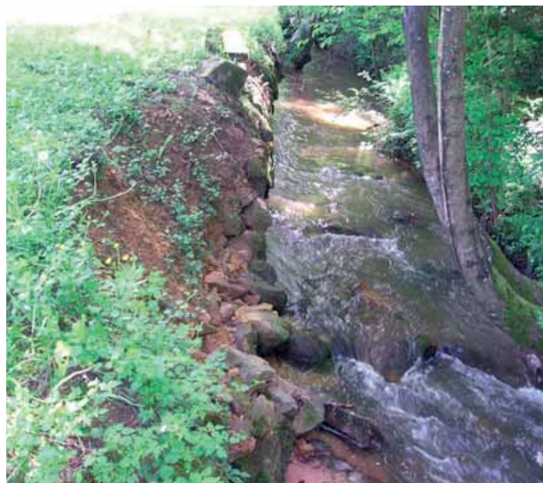
Érosion de berge liée à un fort débit accentué par sa chenalisation
