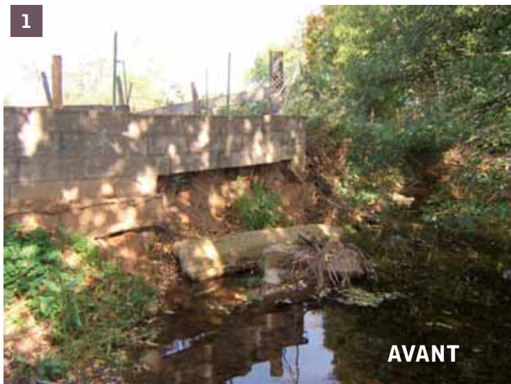
1 Avant : construction d'un mûr trop prêt dans le lit de la rivière
