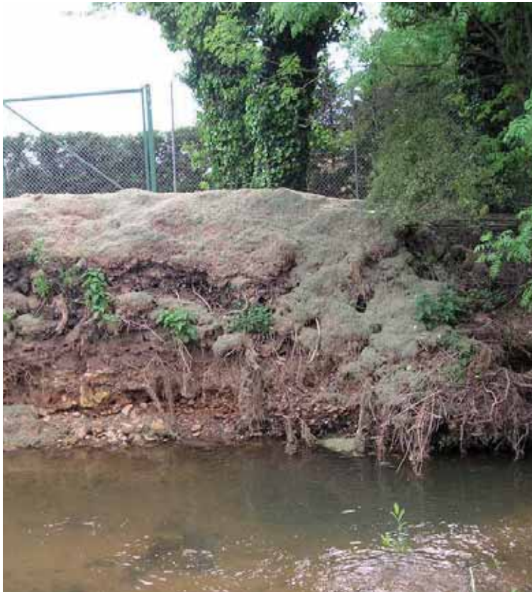
Déchet de tonte nuisible : destruction du sol
