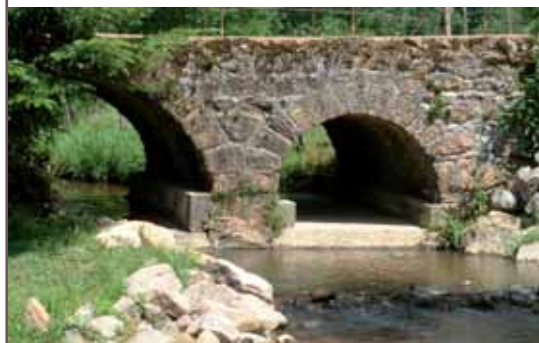
A l'étiage le radier empêche l'eau de circuler correctement
