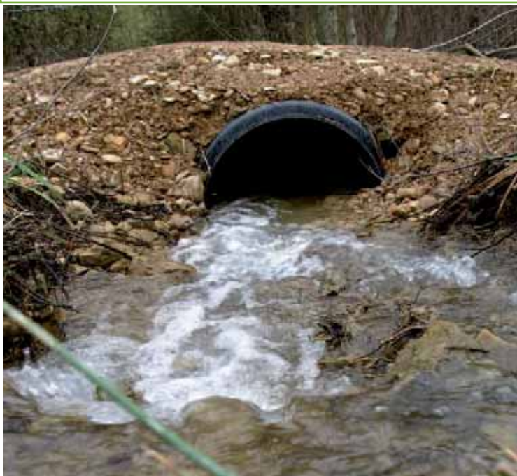
Arche mal implantée = dos d'âne et matériaux lessivables
