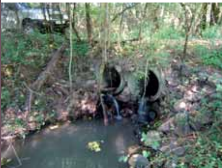
Chute = poisson bloqué et creusement de l'aval
