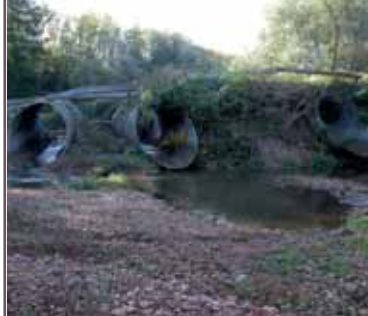
Phénomène progressif de rejet de l'ouvrage par le cours d'eau.
