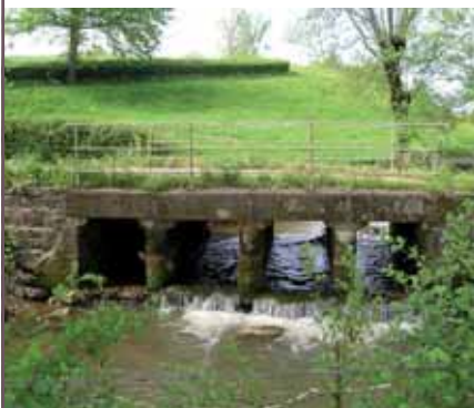
Enfouissement trop faible des buses
