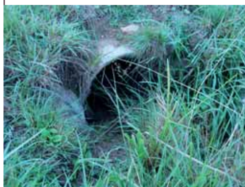
Obstruction par les encombres, inondation des parcelles et érosion en aval
