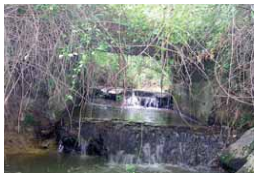
Érosion à l'aval et début d'affouillement du radier et au blocage des sédiments
