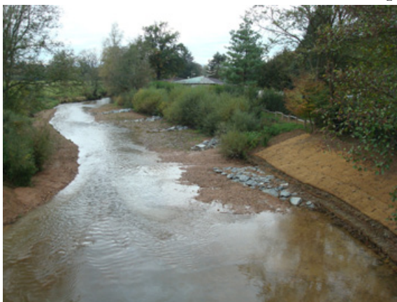
Figure 18 : Épis déflecteurs au niveau du caisson au droit du Camping de Charlieu
