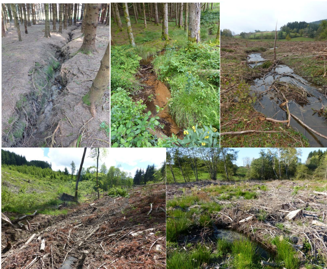
Figure 79 : Dégradations observées sur les ruisseaux en zones sylvicoles : érosion, ensablement, résultats de l'exploitation brutale des parcelles (3 dernières photos)
