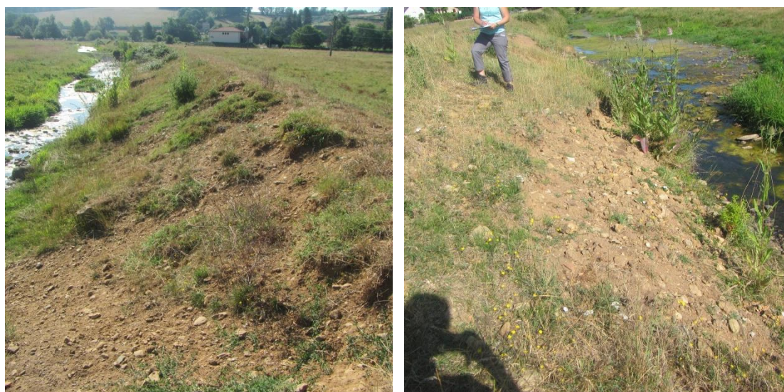
Figure 26 - Zone de glissement et d'affaissement et d'éboulement de talus au TH9
