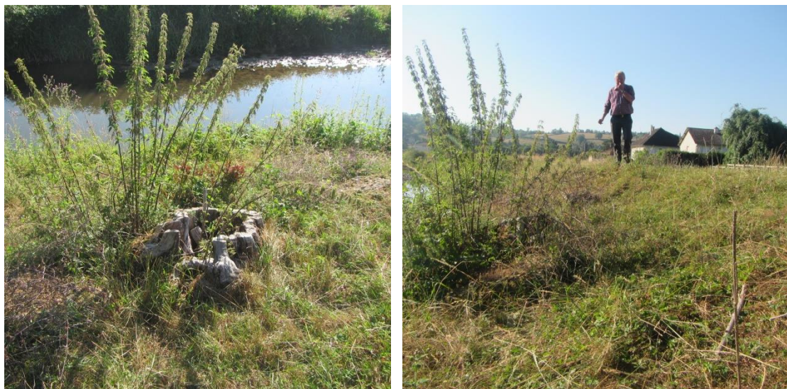
Figure 8 - TH2 : souche dégradée, à gauche et affaissement du talus amont, à droite
