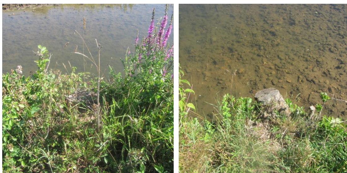
Figure 30 - Souche en talus amont, au TH11
