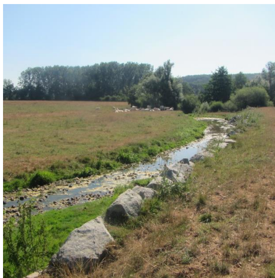
Figure 35 - Affaissement des enrochements au TH14
