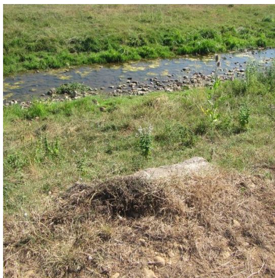
Figure 25 - Arbustes et dalle béton sur le talus amont
