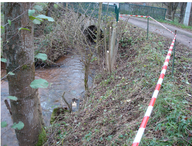
Figure 36 : Érosions au droit du pont de Mars sur le Chandonnet
