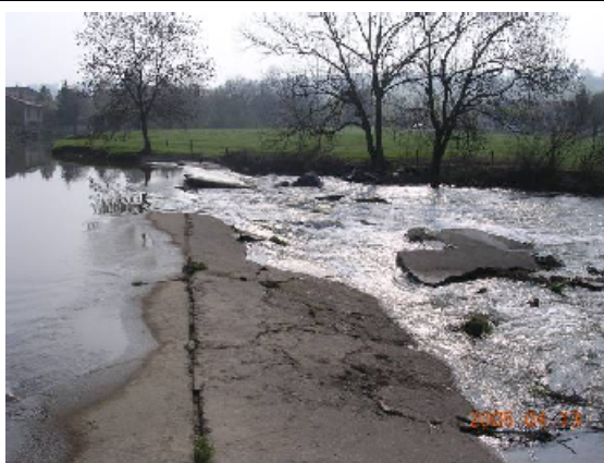
Le seuil des pompiers, très endommagé par la crue de décembre 2003
