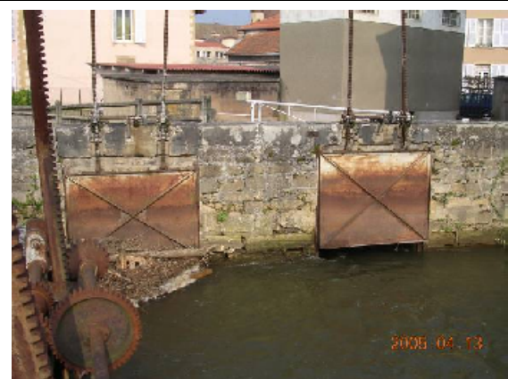
Vannage du bief des pompiers source d'accumulation d'embâcles
