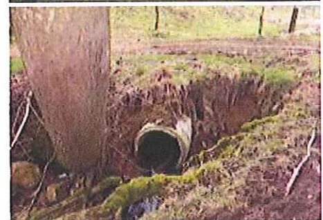
Buse dégradée (Jarnossin de Sevelinges)
