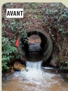
Buse aval à remplacer
