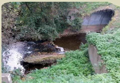
Buse métallique sur le Botoret à remplacer
