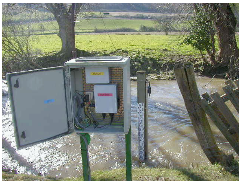
Station hydrométrique (photo DIREN Haute Normandie)
