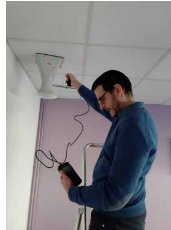
Utilisation d'un thermo anémomètre à fil chaud pour la réalisation d'un pré-diagnostic.
