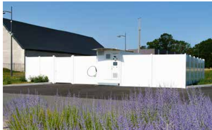
La station de distribution d'hydrogène d'Isoparc
